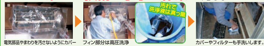
電気部品やまわりを汚さないようにカバー フィン部分は高圧洗浄 カバーやフィルターも手洗します。
